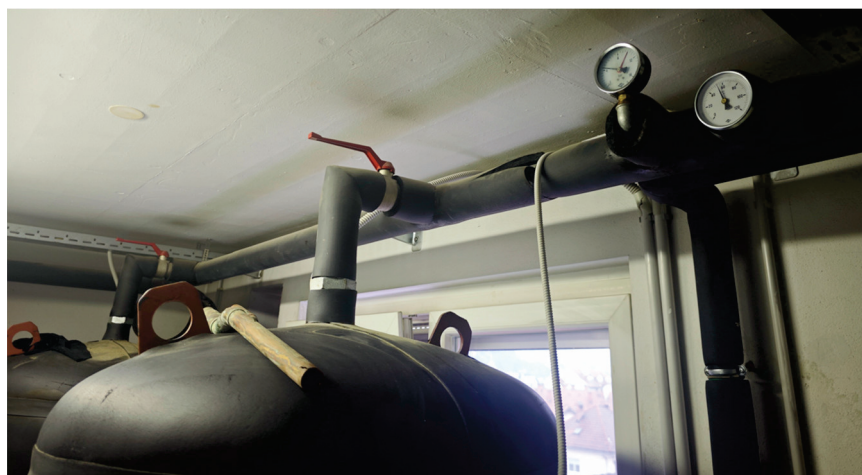
Slika 4.2.2: Obstoječa akumulatorja tople sanitarne vode
