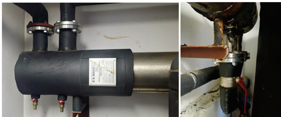
Slika 4.2.1: Obstoječ cevni prenosnik toplote Mago
